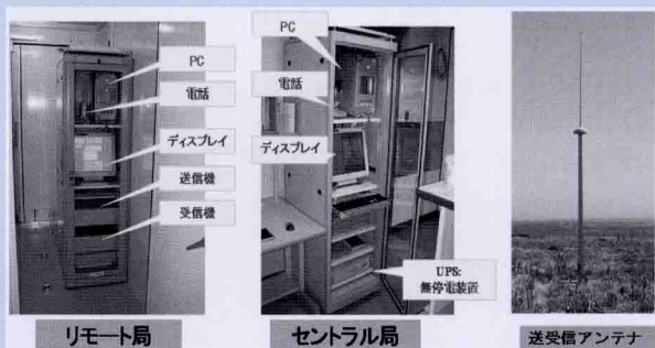
図3：海洋レーダシステム
